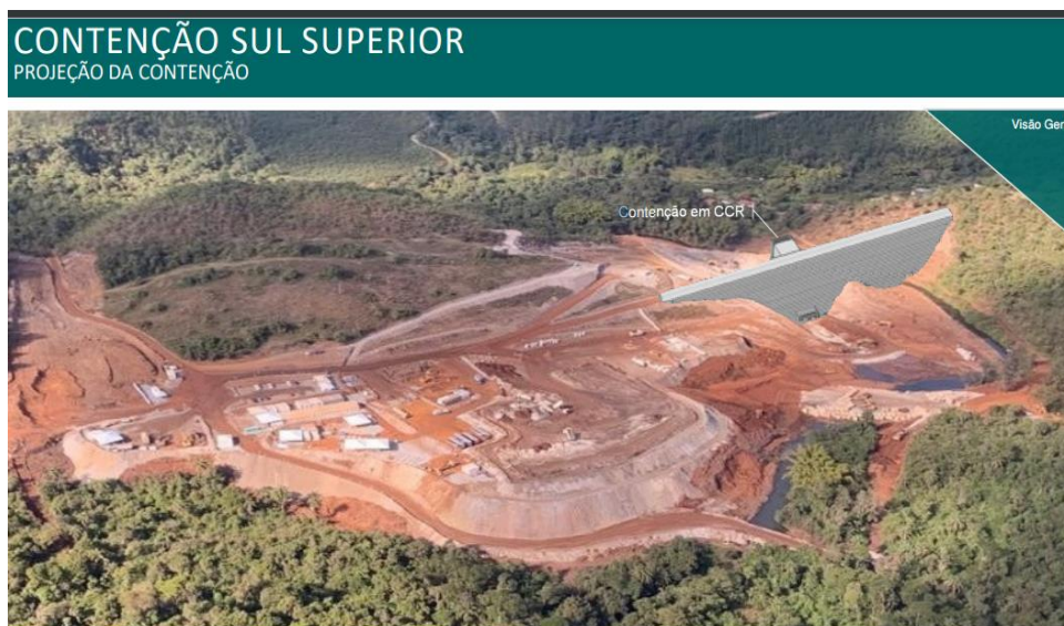
Figura 07 – Construção da contenção em concreto localizada a 6 km à jusante da barragem Sul Superior, em Barão de Cocais.
