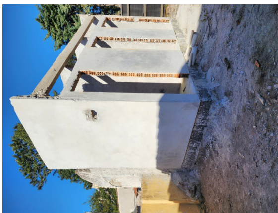
Situação registrada em maio de 2023. Estrutura dos banheiros já construída com viga e encanamento aparente
